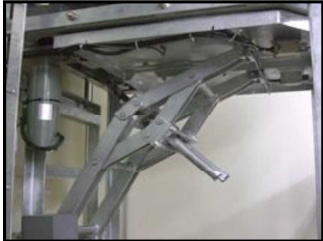
換気口浸水防止機
