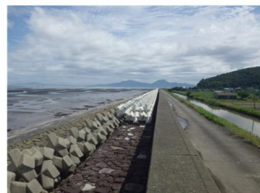
消波ブロック整備状況
