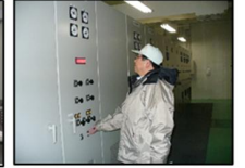
（ポンプの運転）
