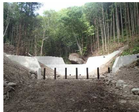
流木を捕捉するタイプの治山ダムの完成状況
