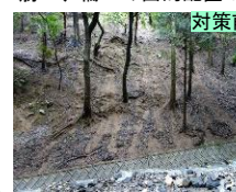
豪雨時の表面侵食状況
