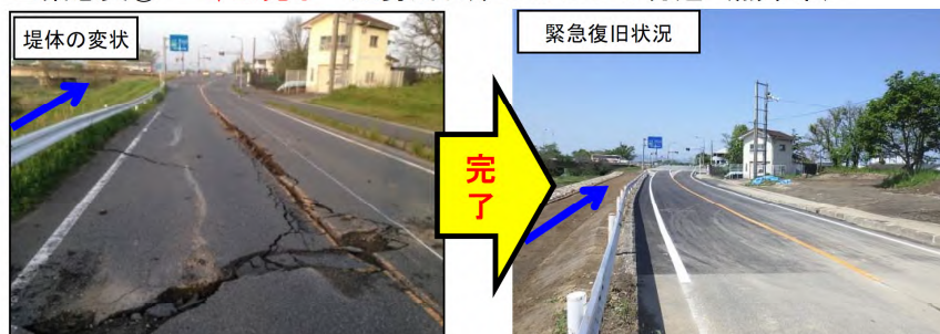
■ 緊急災③ 4/27完了 加勢川右岸 9 k 8 0 0 付近 (熊本市)
