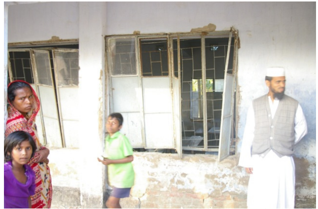
写真－１４ 高潮により破壊されたハイスクールの窓
