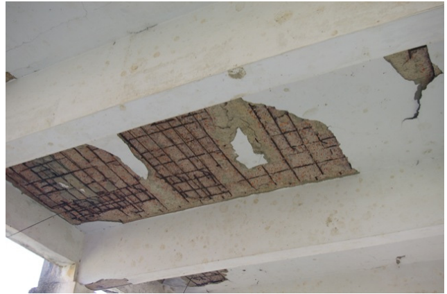
写真－１７ サイクロンシェルターの １階天井の劣化状況
