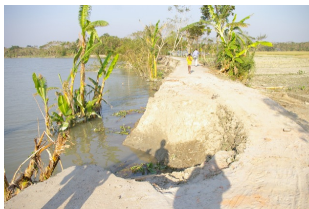
写真－１２ 被害状況 （越流および前面が滑っている）
