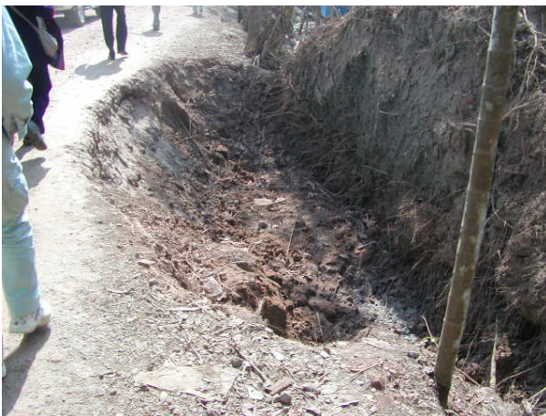
写真－３ 倒木の根堀による道路の裏面の被災
