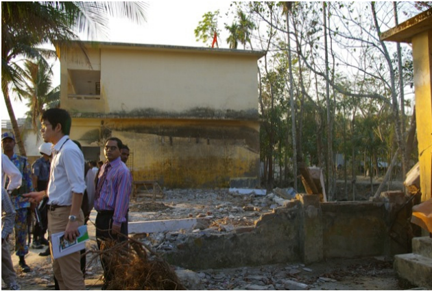
写真－１３ 高潮により破壊されたハイスクール
