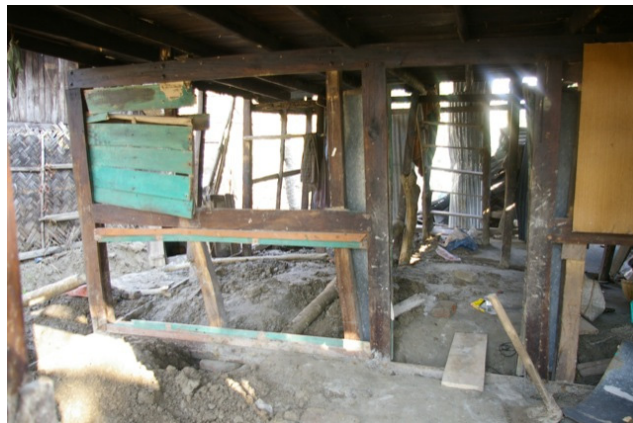
写真－２０ 家屋被害の状況
