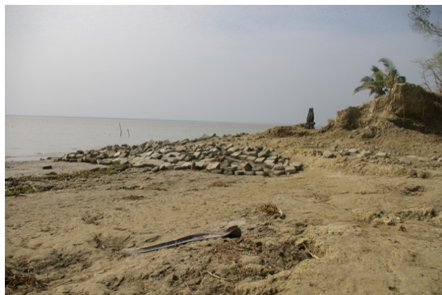
写真－２２ 破堤地点北側の状況
