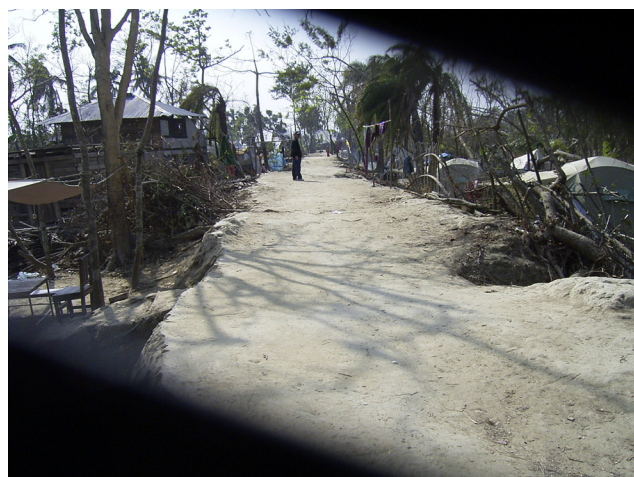
写真-34 堤防被災状況 (左：堤外、右：堤内)
