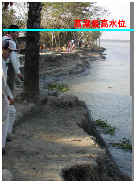
写真－２３ 川沿いの道路 の侵食状況
