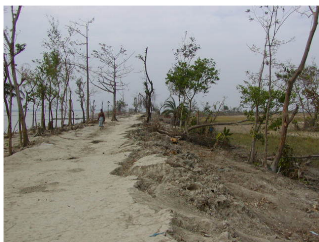
写真-39 被災した堤防
