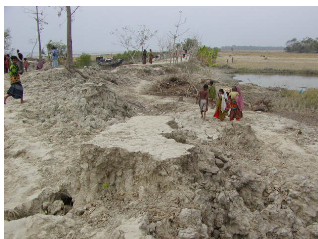
写真-38 堤防被災状況
