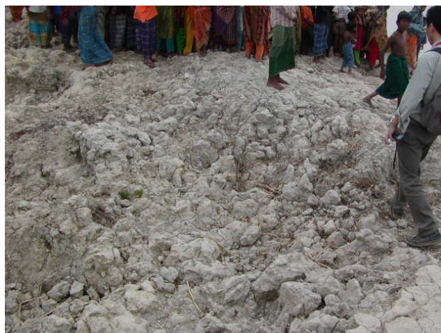
写真-42 堤防の侵食状況
