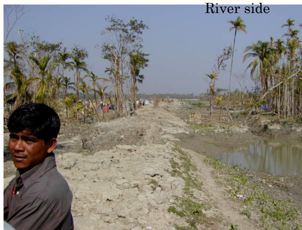
写真－２７ 堤防被災状況
