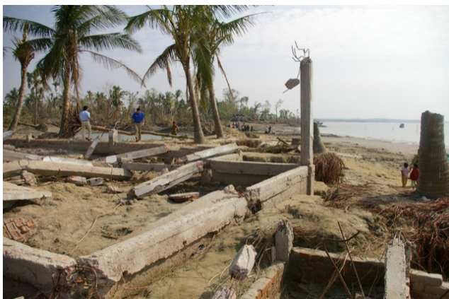
写真－２１ ハイスクールの被害状況
