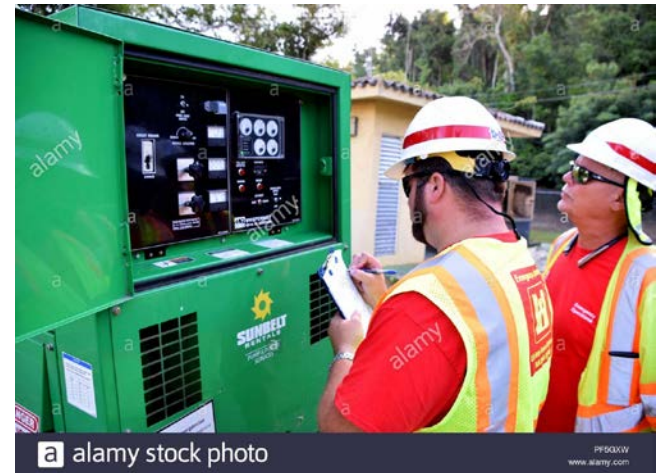
提供された非常用発電機の検査・維持管理
