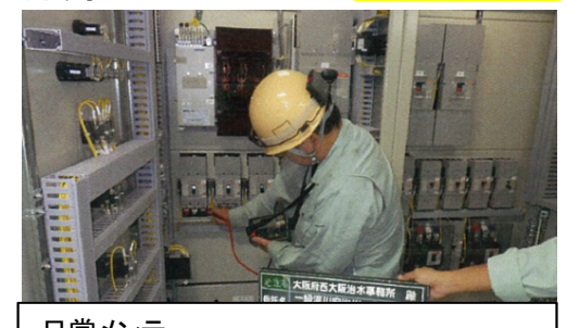
日常メンテ: 主水門制御電源盤点検
