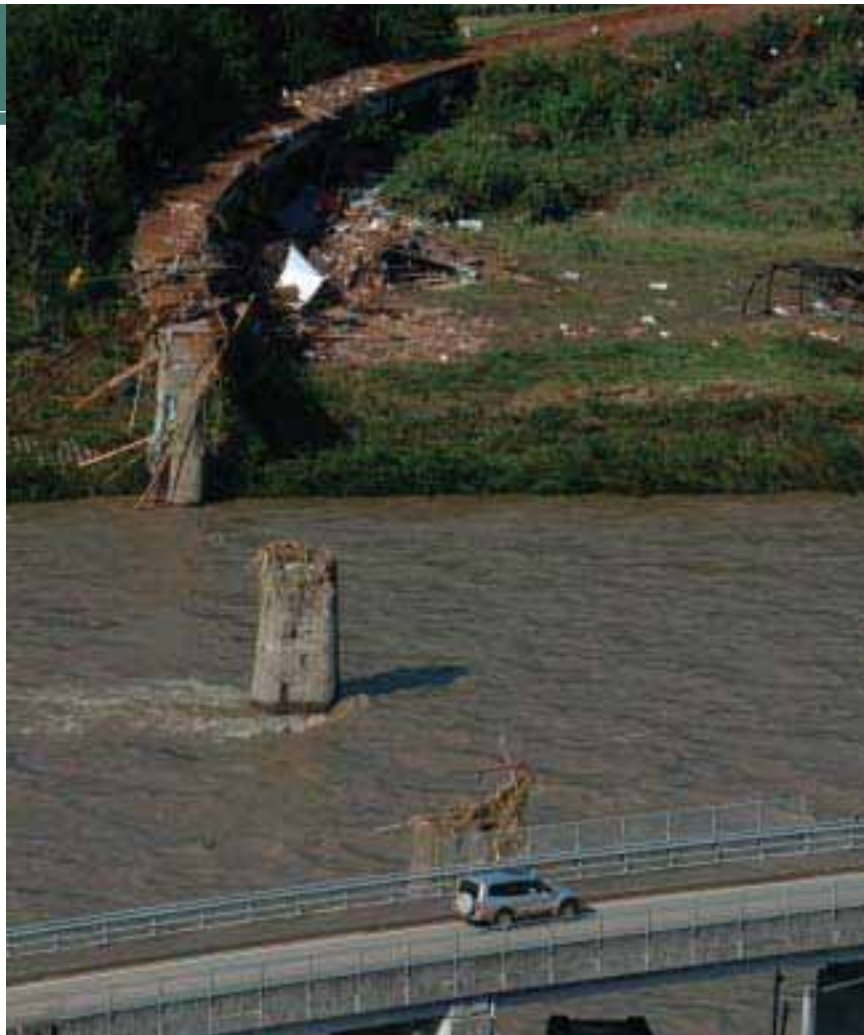
▲橋脚を残して流失した高千穂鉄道の第一五ヶ瀬川橋梁（宮崎県北方町） 〔写真提供／読売新聞社〕
