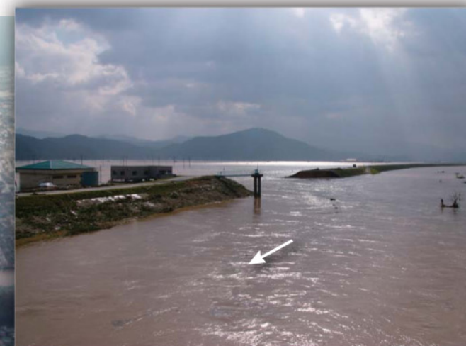
▲ 円山川右岸13.2km破堤状況（兵庫県豊岡市）
