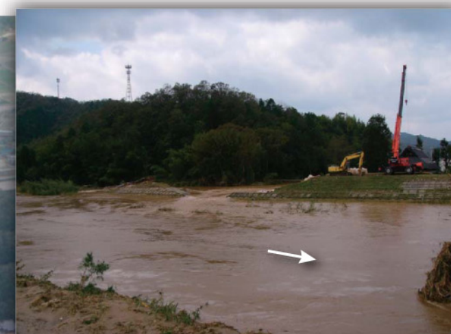
▲ 支川出石川左岸5.4km破堤状況（兵庫県出石町）
