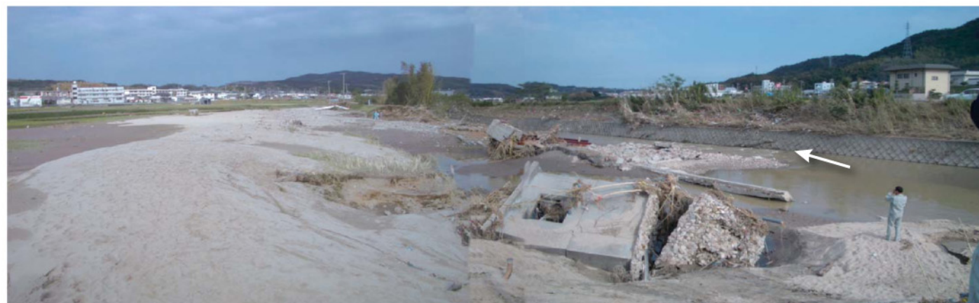
▲ 洲本川左岸破堤状況（兵庫県洲本市上内膳～桑間）
