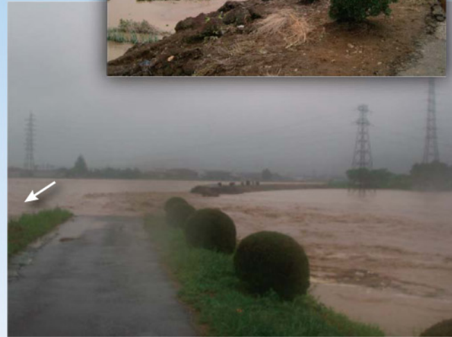
五十嵐川左岸破堤状況（新潟県三条市）
