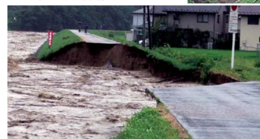
▼ 天竜川の堤防決壊状況（長野県箕輪町）
