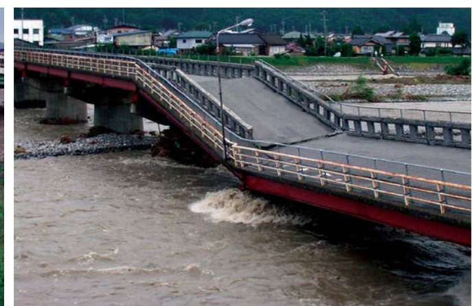
▲ 天竜川の橋梁被災状況（長野県伊那市）
