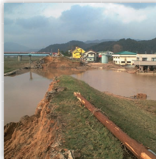
台風23号による堤防決壊(円山川)
