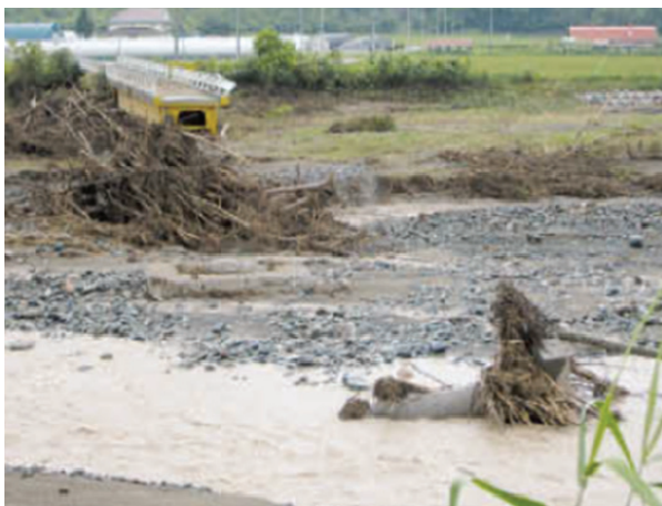
流木等により流失した橋梁
