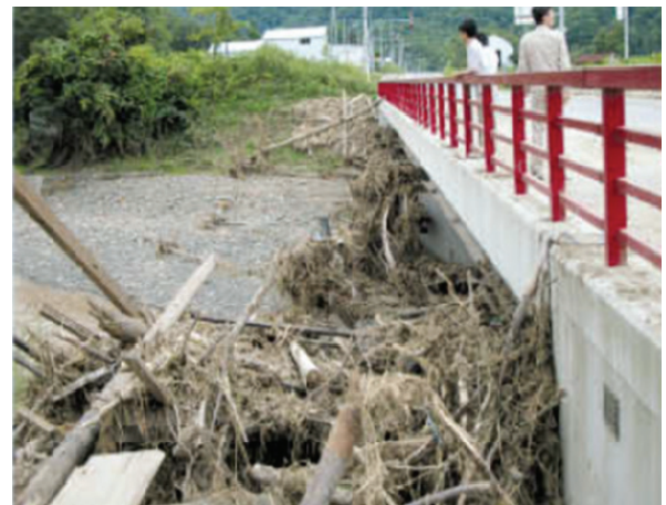
流木が詰まり流下阻害が生じている例
