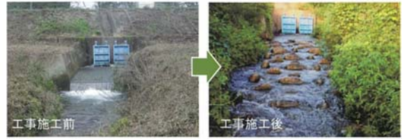
■ 堤外地側（河川との合流地点）の落差の解消
