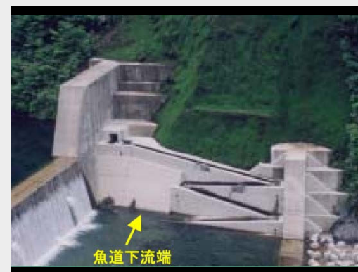
砂防堰堤に設置した魚道
