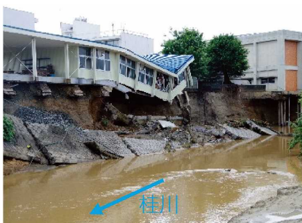
ひらまつ 比良松中学校の被害状況 (福岡県朝倉市)
