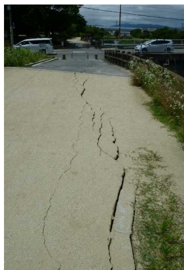
天野川護岸天端クラック状況 (大阪府交野市星田)
