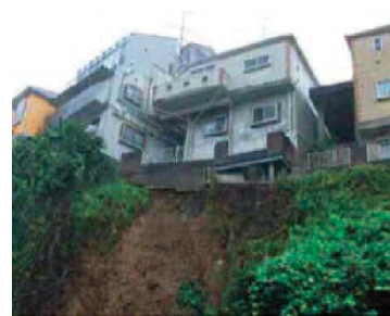
金沢区の被害状況 (神奈川県横浜市)
