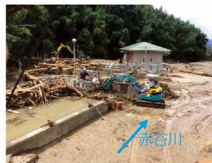
はき 杷木浄水場の被害状況 (福岡県朝倉市)
