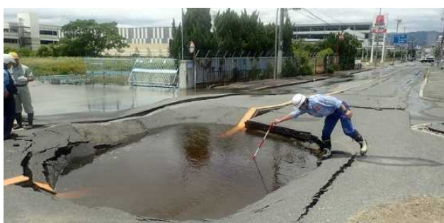
水道管破裂による道路陥没
