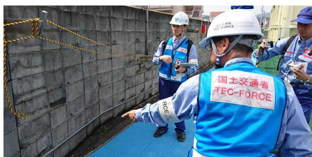
ブロック塀の亀裂等確認 (大阪府高槻市)
