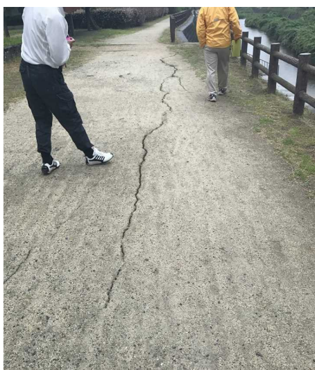
天野川護岸天端クラック状況 (大阪府交野市星田)
