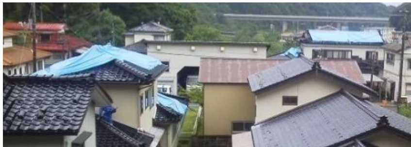
屋根瓦落下等（ブルーシートで養生）（鶴岡市）
