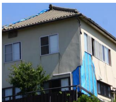
被災地の家屋外壁の状況
