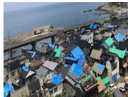
被災地の屋根瓦の状況
