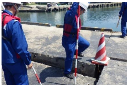
ねずがせき 鼠ヶ関港の被災状況調査（鶴岡市）
