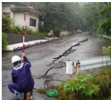
道路の被災状況調査（鶴岡市）
