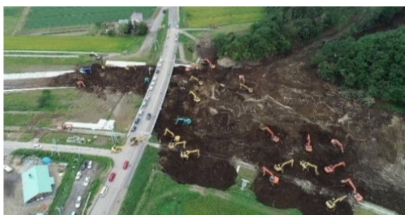
24時間体制で河道閉塞箇所における土砂撤去作業 (北海道勇払郡厚真町・厚真川幌内橋付近)
