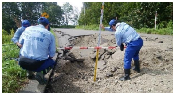
自治体所管施設の被災状況調査 (北海道勇払郡安平町)
