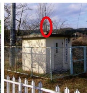
雨量計の整備
