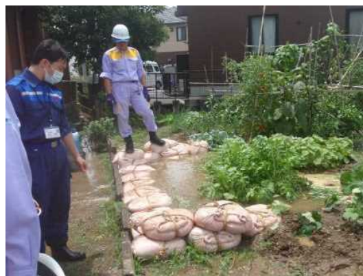
ほんじょう かまだん 岐阜県岐阜市本荘水防団 釜段工を実施 ながら (令和2年7月8日：長良川左岸)
