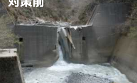
常時流水の影響による摩耗の進行
