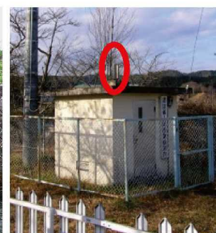
雨量計の整備
