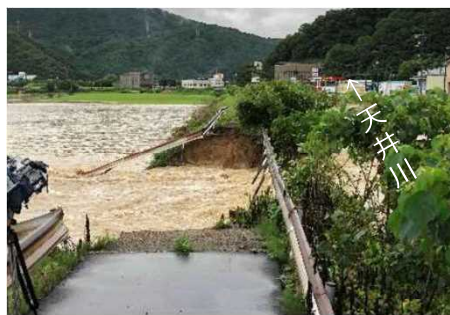
ぬた てんじょう 沼田川水系天井川の堤防決壊 みはら (広島県三原市)
