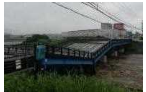
きせ 黄瀬川大橋の被害状況 ぬまづ (静岡県沼津市)
