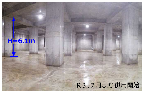
北部中央雨水調整池
