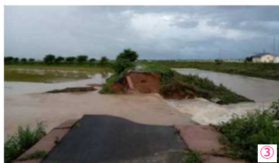
かけはし なべたに 梯川水系鍋谷川の堤防決壊 (石川県 小松市)
