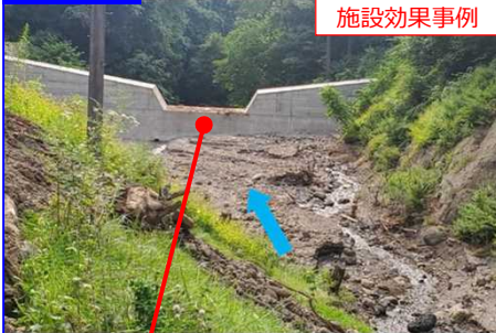
8/6 土石流等 長野県小川村稲丘
