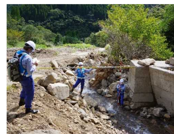
河川施設の被災状況調査 （宮崎県西米良村）
