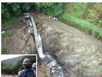
ドローンでの被災箇所確認 （宮崎県諸塚村）
