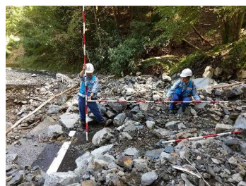
道路の被災状況調査 （宮崎県椎葉村）
