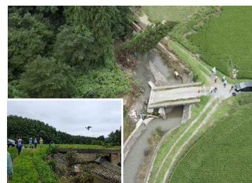
ドローンによる被災状況調査 (青森県中泊町)
