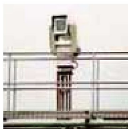
CCTVカメラの整備
