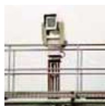
CCTVカメラの整備
