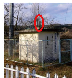
雨量計の整備
