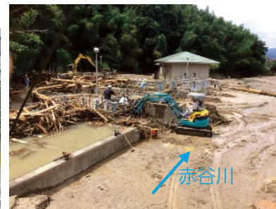
はき 杷木浄水場の被害状況 (福岡県朝倉市)
