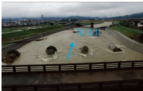
きゅうだいほんせん JR久大本線の鉄道橋の流出状況 (大分県日田市)
