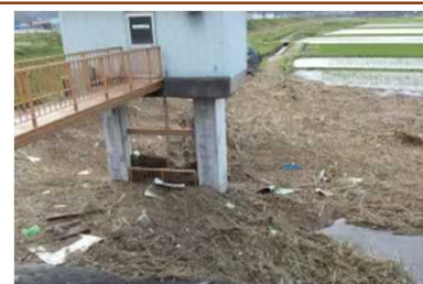
河川管理施設周辺の堆積事例
