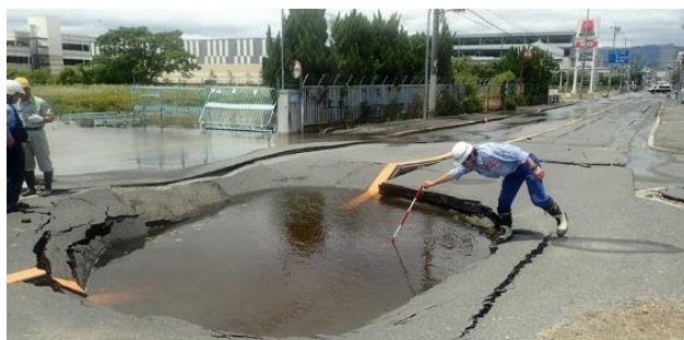
水道管破裂による道路陥没
