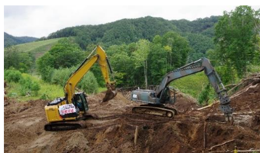
関係機関と連携した道路啓開 ゆうふつ あつま (北海道勇払郡厚真町)
