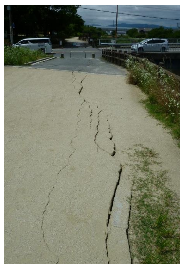
天野川護岸天端クラック状況 かたの ほしだ (大阪府交野市星田)
