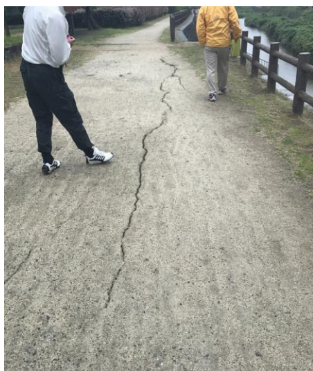
天野川護岸天端クラック状況 かたの ほしだ (大阪府交野市星田)
