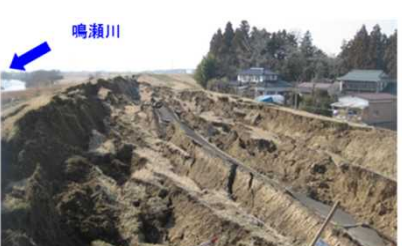
H23地震による堤防被災
