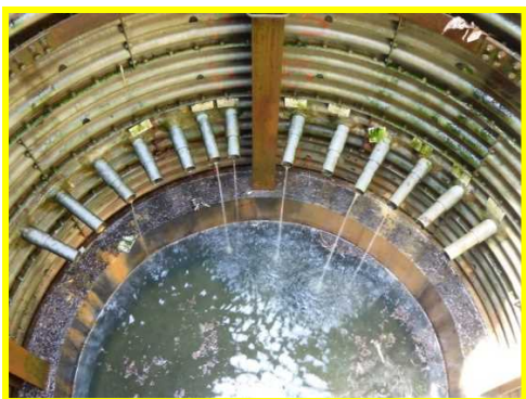
同地区内の既設集水井工
