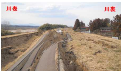
H23東日本大震災による堤防被災
