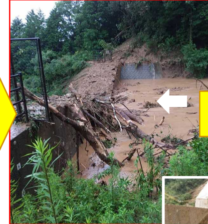
土石流発生直後(R2.7.7撮影)
