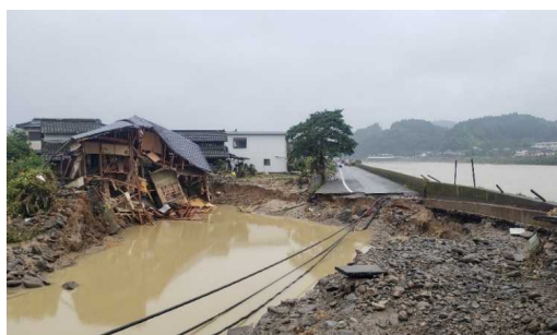
球磨川堤防の破傷状況 ひとよし (熊本県人吉市)
