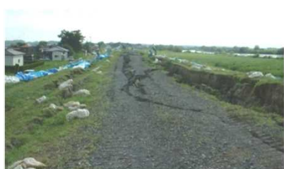
H15地震による堤防被災
