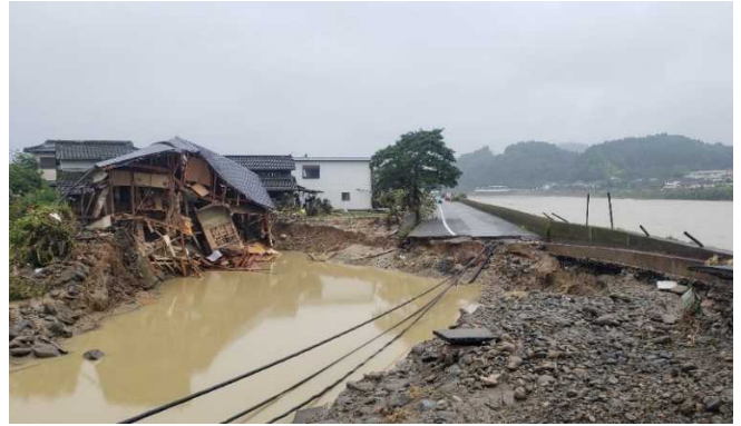
くま 球磨川堤防の破損状況 ひとよし (熊本県人吉市)
