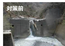
常時流水の影響による摩耗の進行
