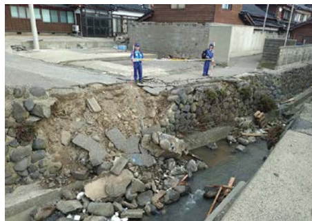
河川の被害状況調査 （石川県志賀町）
