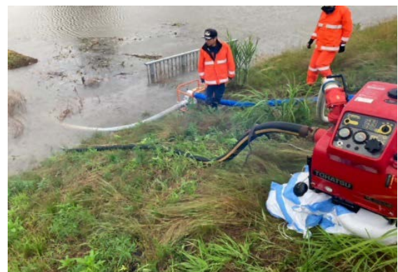
だいせん 秋田県大仙市消防団 排水活動 （令和5年7月15～18日） なんがい 南外地区
