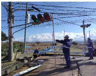
道路の被災状況調査 （石川県内灘町）
