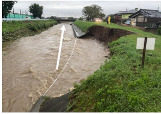
三渡川水系堀坂川の堤防被災状況 (三重県松阪市)
