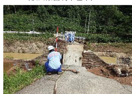
被災状況調査（道路） （山形県鮭川村）
