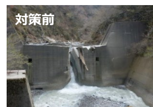
常時流水の影響による摩耗の進行
