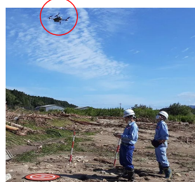
被災状況調査(砂防) (石川県輪島市)
