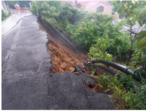
土砂災害の状況 (静岡県熱海市)
