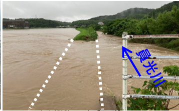
かんだがわ かすみつがわ 神田川水系真光川堤防決壊状況 しものせき (山口県下関市)
