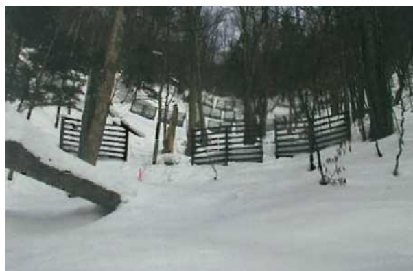
● 雪崩予防柵工(長野県松本市安曇)
