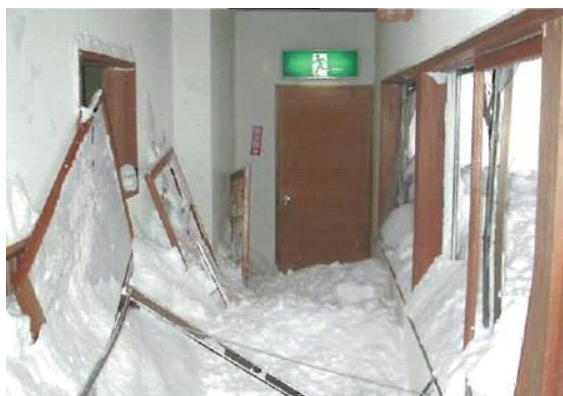
● 住宅被害状況(長野県松本市安曇)
