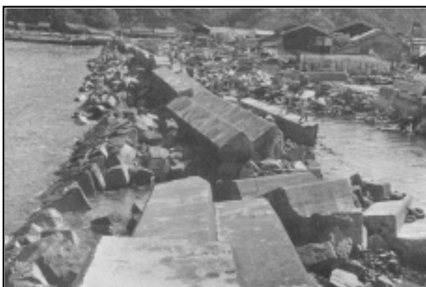
崩壊した港湾施設 (三重県北牟婁郡長島港)
