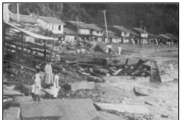
護岸築堤決壊 (三重県海山町)
