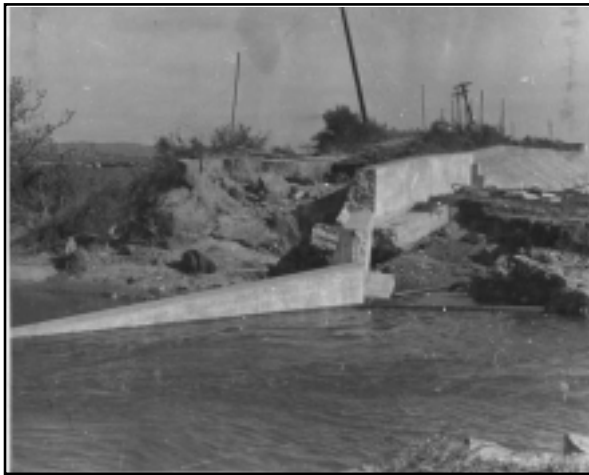
高潮に破壊された護岸
