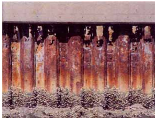
写真 2.9.1-1 老朽化した護岸の状況 (塩浜地先)
