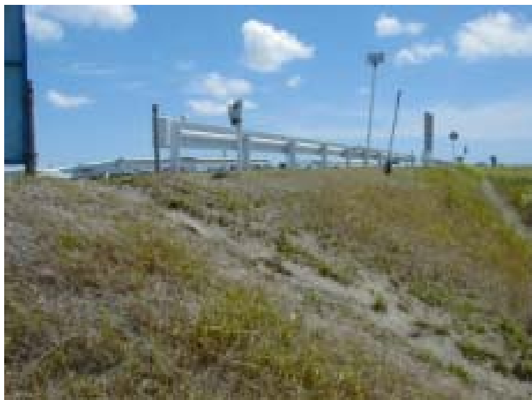
雨水による土砂の流出
