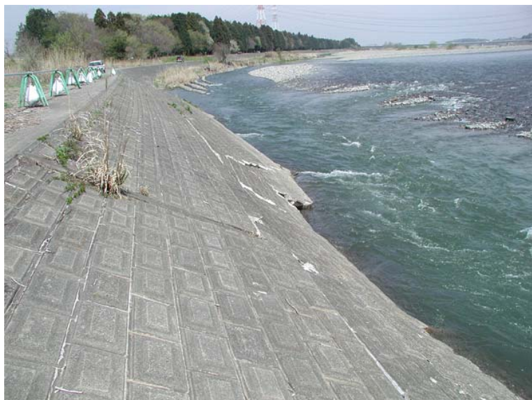
コンクリート護岸の破損
