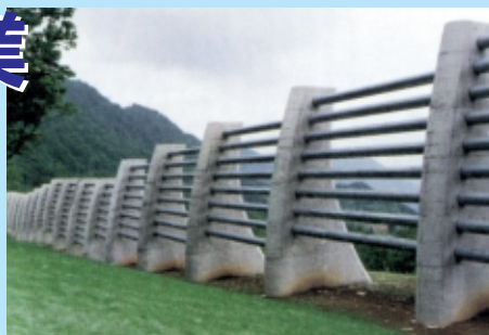
雪崩防護工 (新潟県中魚沼郡津南町)
