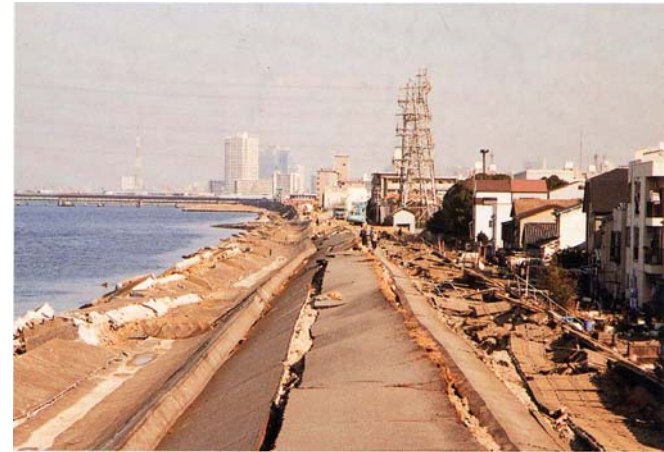
平成7年兵庫県南部地震 淀川
