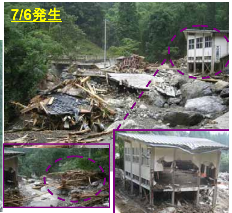
7/6発生 全壊した「柏川集会所」 全壊した「社会教育センター」 ↑ 熊本県下益城郡美里町楠根草
