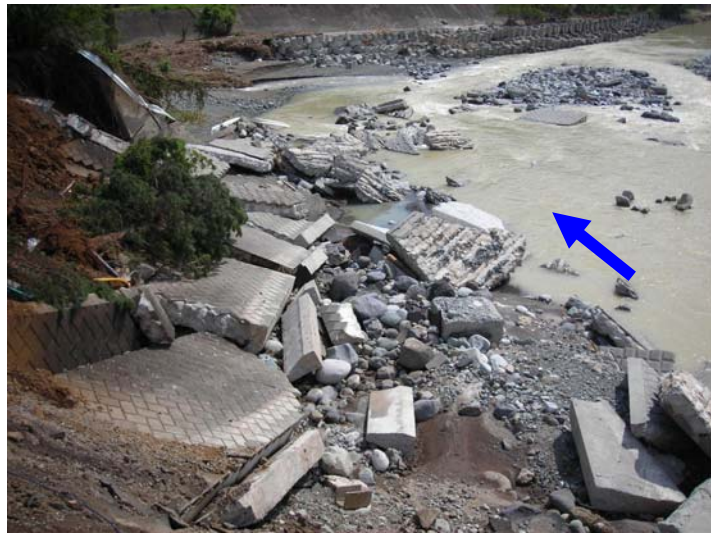
護岸被災延長 約 80 m
