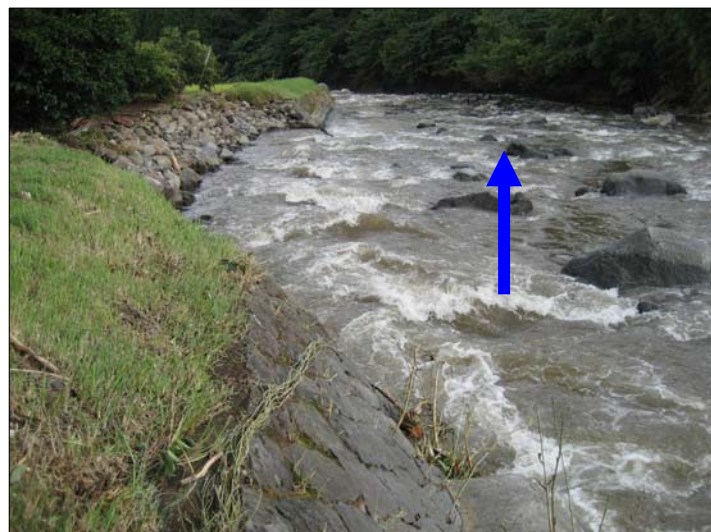
護岸被災延長 約 75 m
