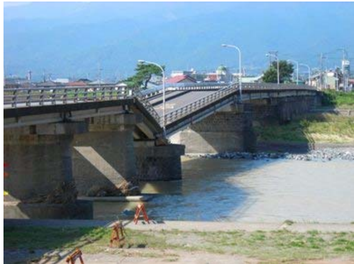
被災内容 落橋
