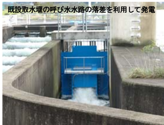
日野川堰小水力発電所（日野川水系日野川）
