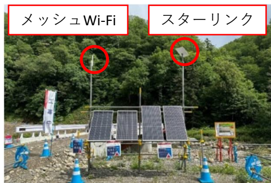
不感地帯において通信環境を確保 （メッシュWi-Fi＋スターリンク）
