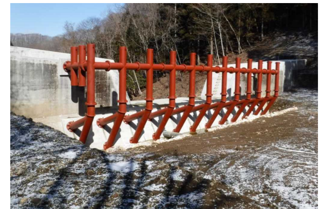
既設砂防堰堤に設置するタイプの流木捕捉工
