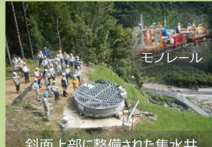
斜面上部に整備された集水井
