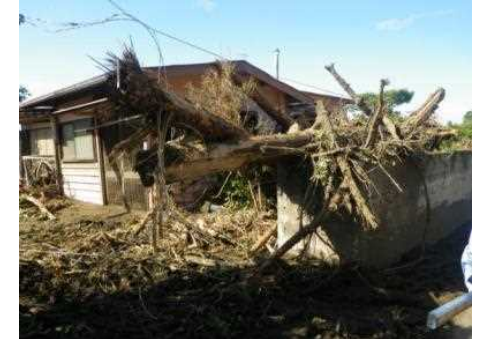
流木による家屋の損壊
