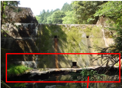
①砂防堰堤の基礎洗掘
